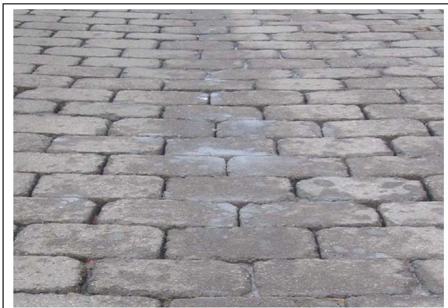
Abbildung 5-14: Vorhandenes Schadensbild in der Liederbacher Straße (an die Oberfläche gespültes Bettungsmaterial)
