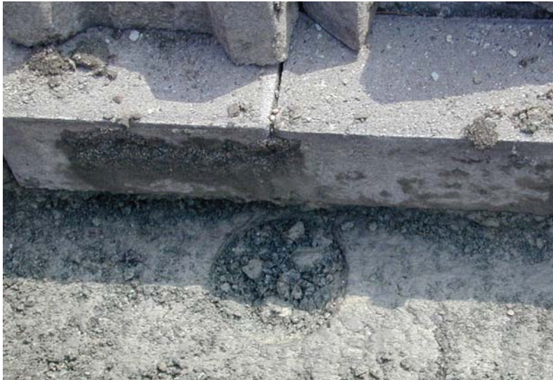
Abbildung 3-1: Für die Versickerung nicht mehr nutzbare Bohrlöcher
