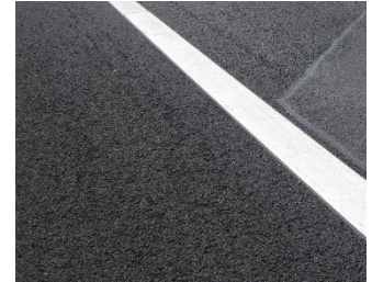
Typische Schadensbilder Offenporiger Asphalte auf Bundesautobahnen
